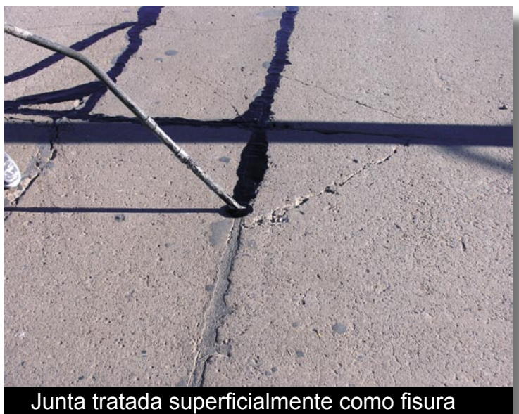
Fisura en pavimento de hormigón
